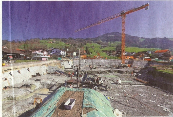
Blick von einem der beiden Baukräne in die Grossbaustelle Husmatt. Archivbild Urs Affolter
